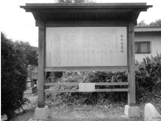
解説板は全体に塗装が剥げてきていて、腐食の原因になるため、塗り直しをします。
