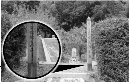
墓所入口の標柱。根本にヒビが入っているので、埋めて塗り直しをします。
